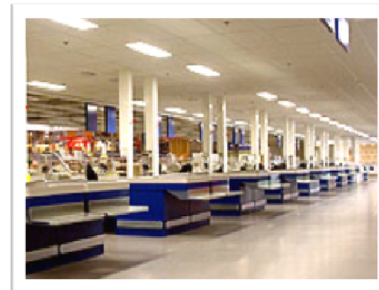
Instalacje transportu pneumatycznego do odbioru pieniędzy z kas w supermarketach
